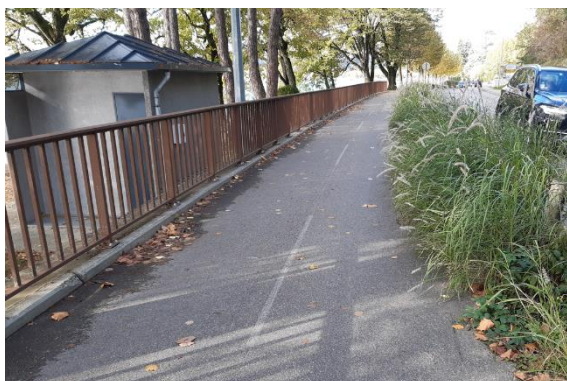
Annecy Petit port - La végétation fait perdre jusqu'à 30 cm de largeur utile à la voie verte.
